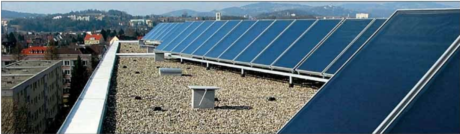
Die Solaranlage am Dach eines Gebäudes in der Linzer Stadlerstraße überzeugte bei der Energiesparmesse.
